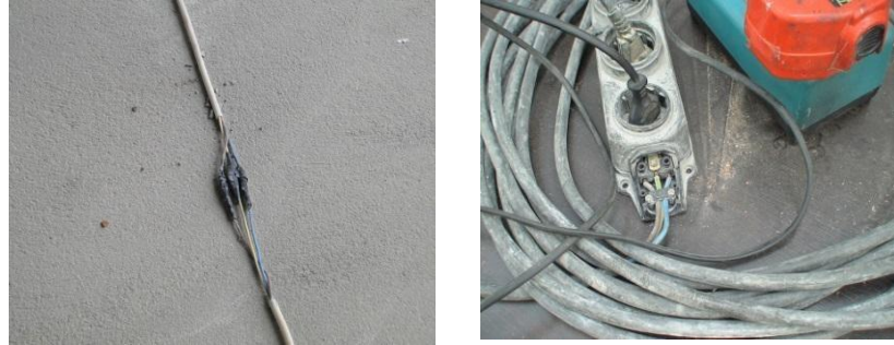
Resim 56 : Deforme olmuş elektrik kablosu
