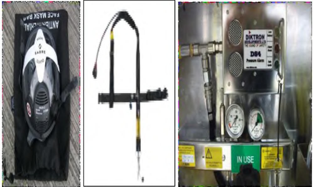
Resim 66: Purge air solunabilir hava hattı aparatları
