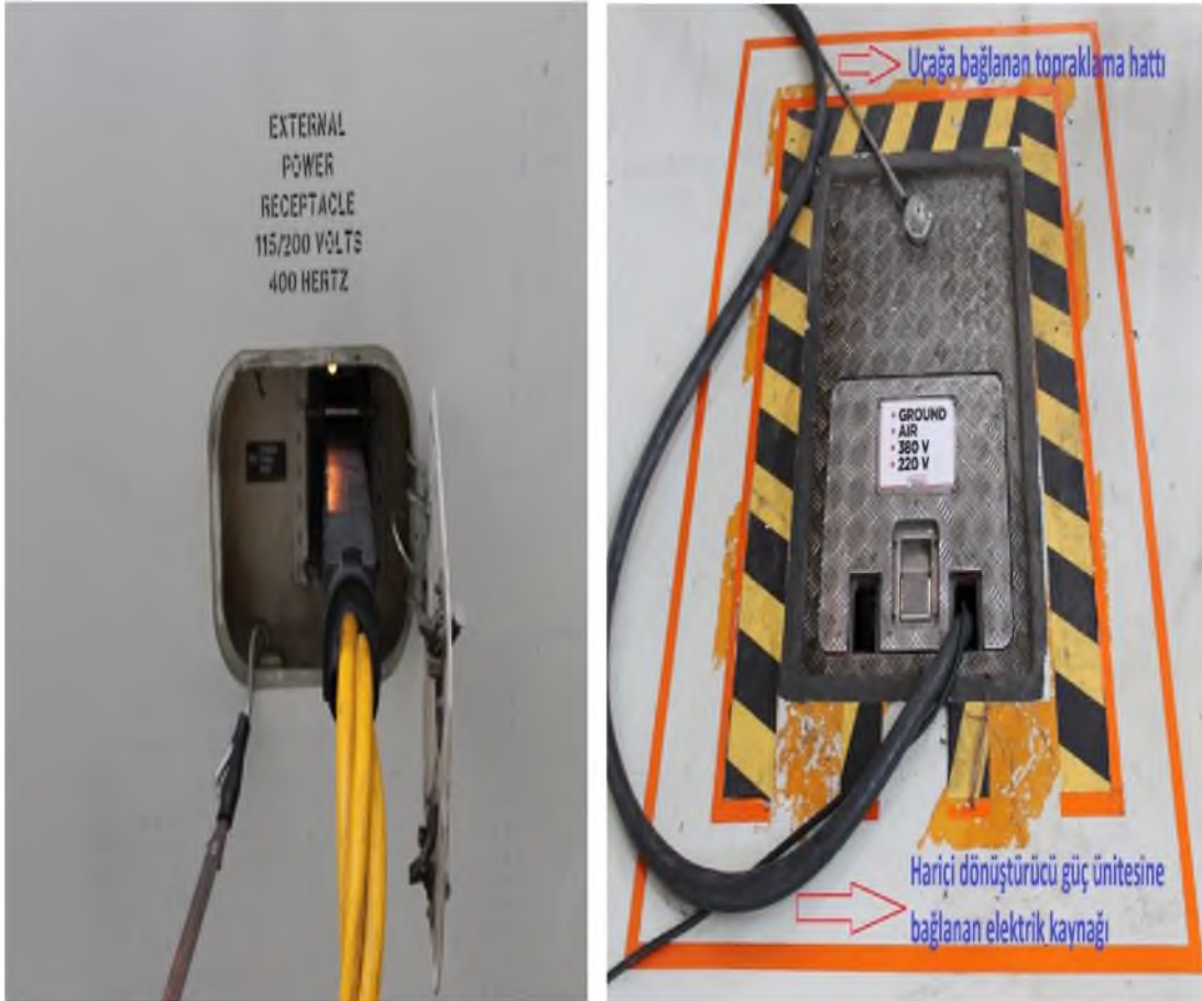
Resim 97: Uçak üzerindeki harici güç girişi Resim 98: Hangar zemininde bulunan pit
