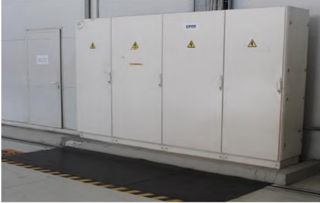
Resim 100: Elektrik dolapları önündeki anti – statik paspas
