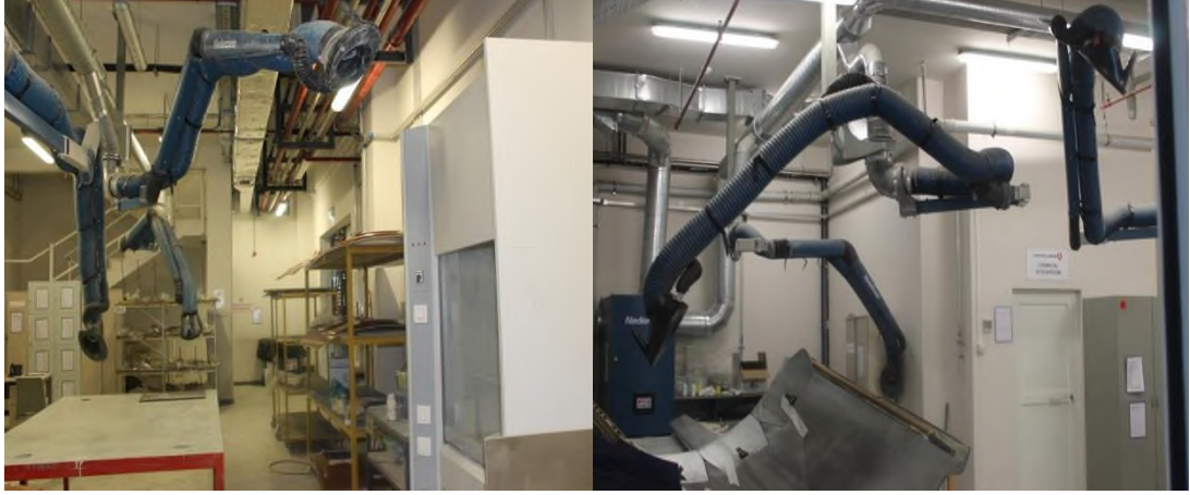
Resim 92: Ahtapot kollu toz emiş sistemi kaplama, kompozit ve panel atölyelerinde kullanılır
