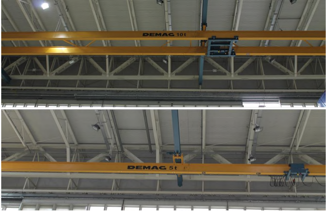
Resim 75: Hangar tavanlarında bulunan vinçler (kreynler)
