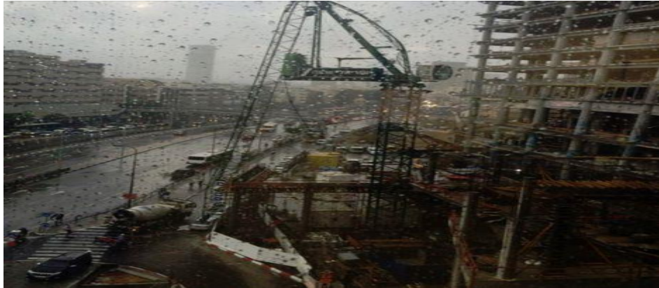
Şekil 34: İsrail-Tel Aviv'de Meydana Gelen Kule Vinç Kazası ( http://www.craneaccidents.com/2015/10/report/tower-crane-jib-tel-aviv/ ).
