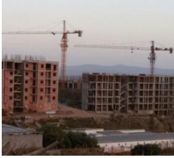
Şekil 37: Cezayir-Bejaia'da Meydana Gelen Kule Vinç Kazası ( http://www.craneaccidents.com/2016/08/report/fatal-tower-crane-incident-4/cezayir ).
