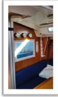
Resim-5.16. Özel tekne yaşam alanında yangın ihbar sistemi uygulaması (17 Aralık 2016 tarihinde çekilmiştir)
