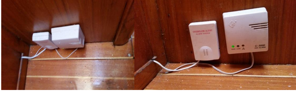
Resim-5.13 Makine bölümünde yangın ihbar sistemi uygulaması (15 Aralık 2016 tarihinde çekilmiştir)
