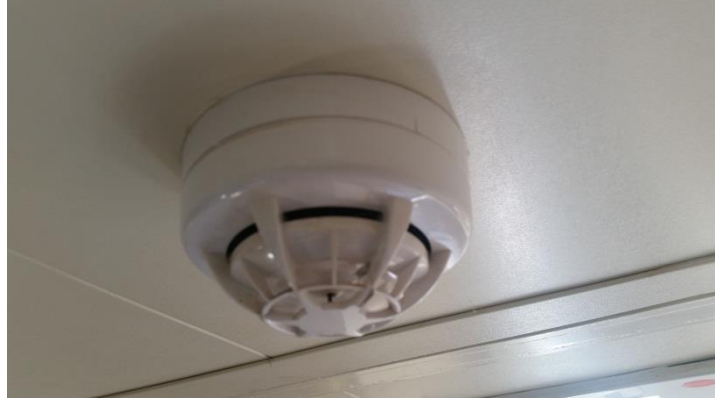
Resim-4.7. Yangın ihbar sistemleri(11 Aralık 2016 tarihinde çekilmiştir)
