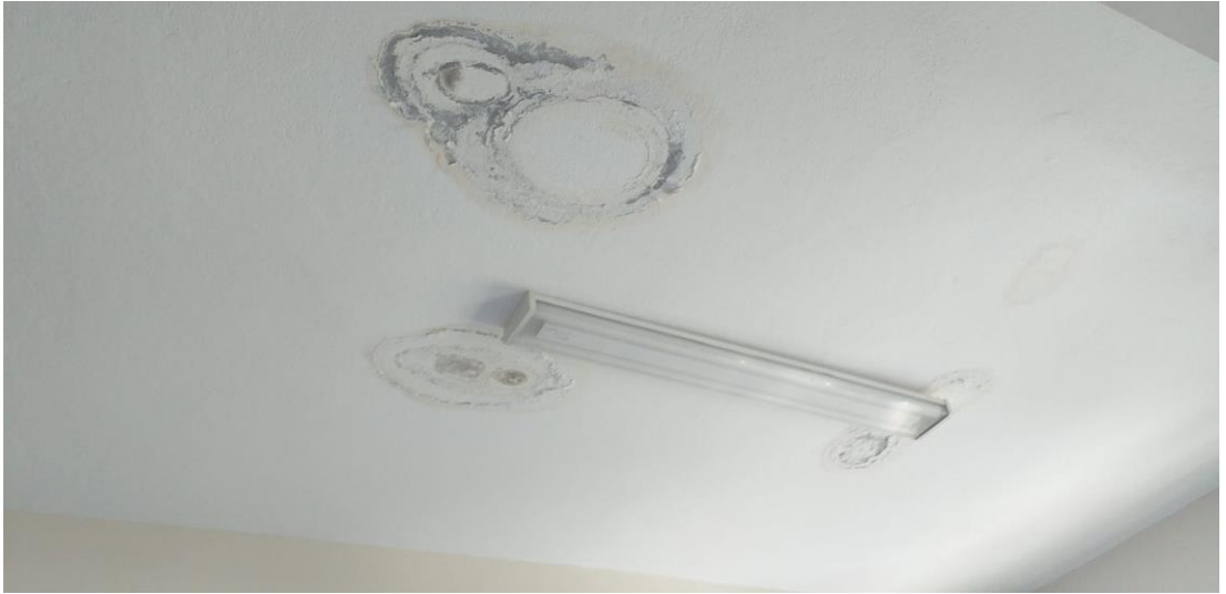
Şekil 3.1: Çatıda Oluşan Su Sızıntısı
