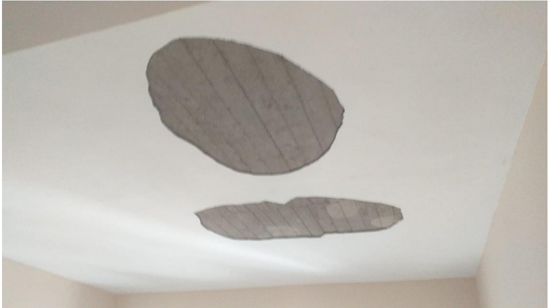
Şekil 3.2: Tavanda Oluşan Sıva Dökülmesi
