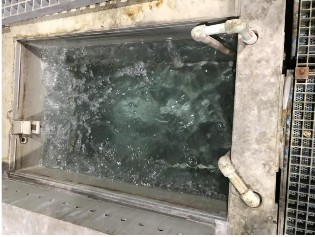
Şekil 4.16: Akar Yıkama Havuzu
