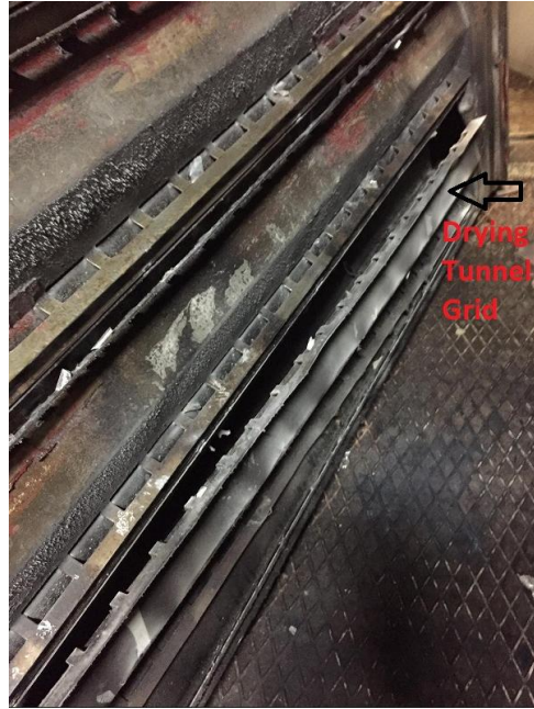
Şekil 6.11 : Yangın Sonrası Kurutucu Tünel Alt Izgaralarda Meydana Gelen Hasar ve Kararma
