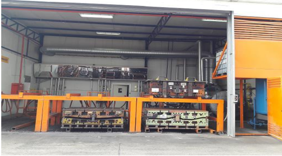
Şekil 5.24: Ön Isıtma İstasyonu
