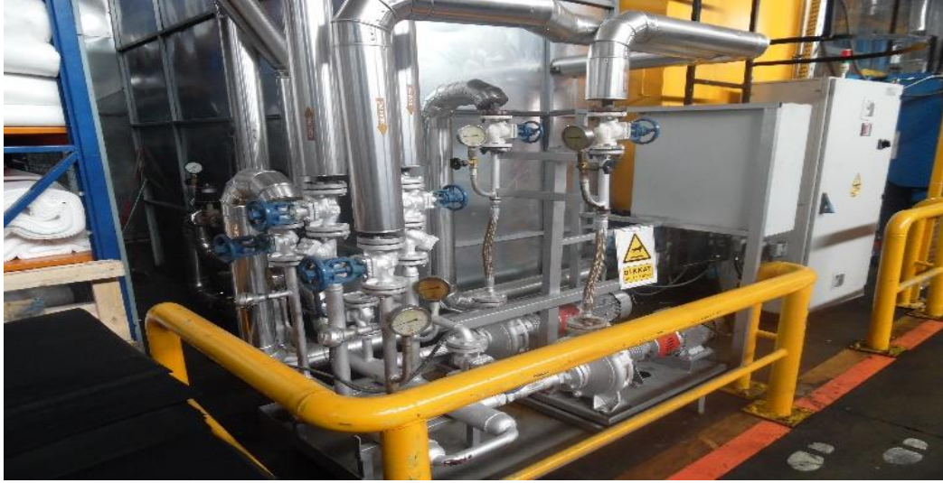
Şekil 5.7: Pres Makinesi Kızgın Yağ Boru Hatları
