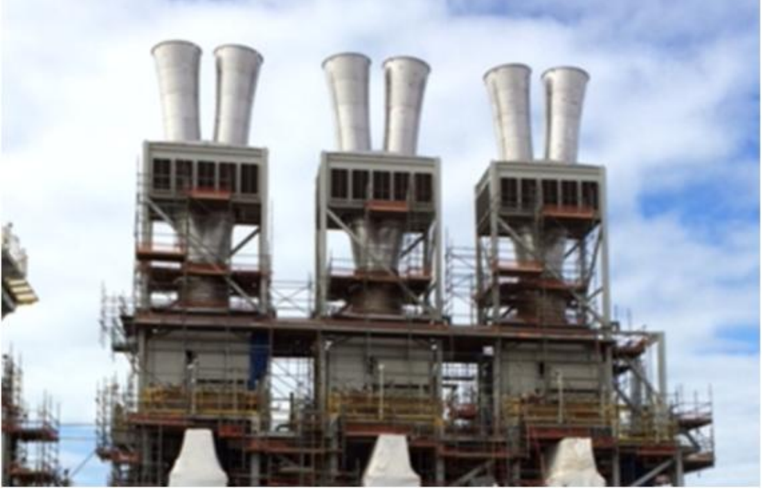
Şekil 4. 2: Gaz ve Buhar Türbinleri Egzoz Soğutma (Marin ve Kara Enerji Tesisleri)
