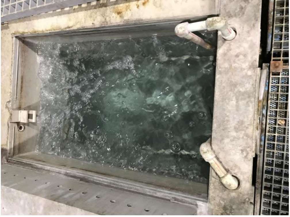
Şekil 4.16: Akar Yıkama Havuzu
