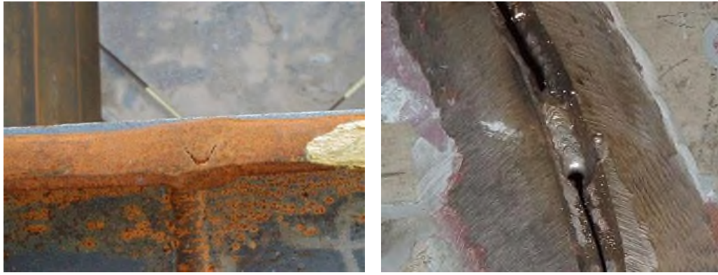
Resim 5.3 Tank Yan Kapama Kaynağında Yetersiz Ergime ve Nüfuziyet Hatası
