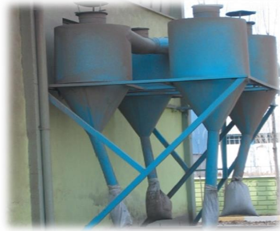
Resim 3.2 Toz Toplama siloları yüzeyinde biriken asbest tozlar (Arseven ve ark., 2005)
